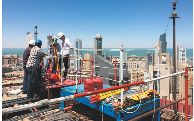
Contrôle des coffrages des murs porteurs à l'aide d'une station totale utilisant les points actifs GNSS - Tour NBK au Koweït
