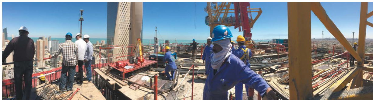
Les 3 points actifs GNSS sur la plate-forme supérieure de la nouvelle tour NBK au Koweït.
